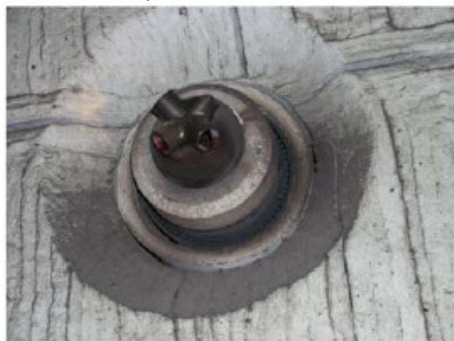
Рисунок 4 – Сопло горелки с плоским факелом внутри печи
